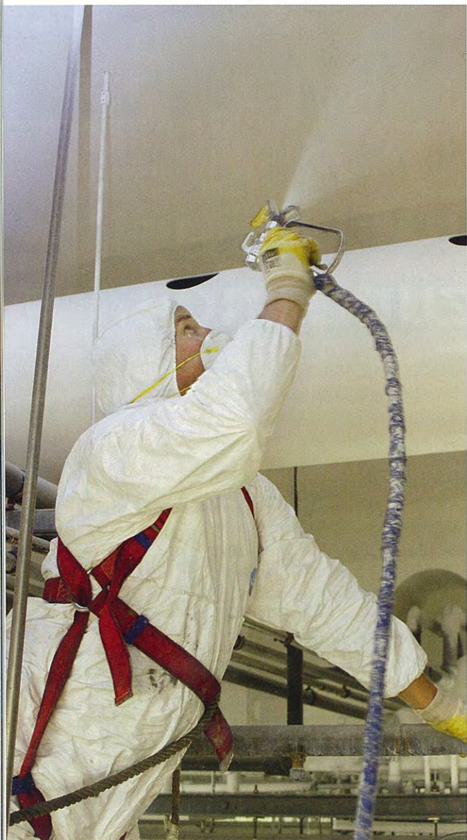
Die „Silberfarbe“ kann direkt auf die schimmelbefallene Oberfläche aufgetragen werden.
